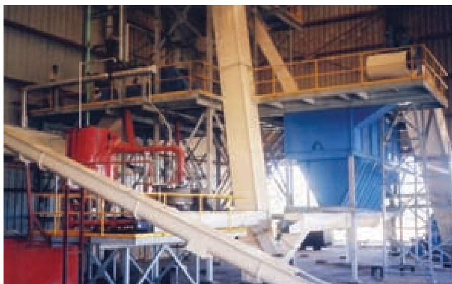
Las máquinas trabajando en la planta extractora Propalma en Acapetahua, Chiapas.
